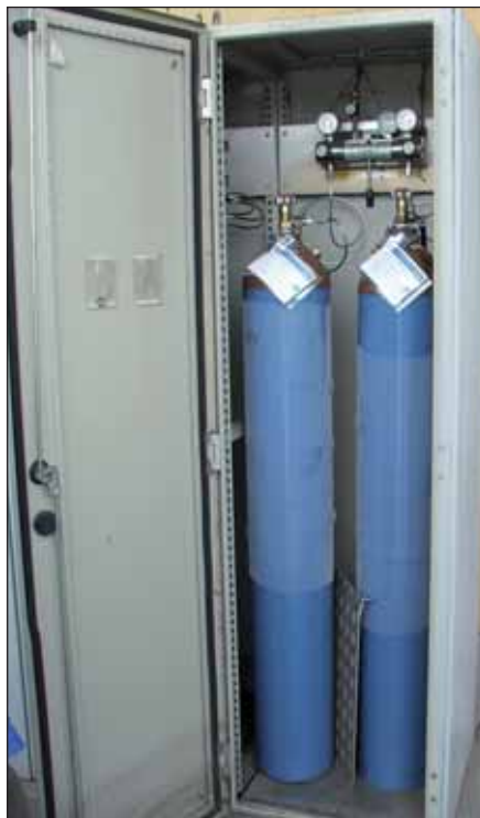
Obrázek 14: Připojení lahví helia na rozvod plynu v laboratoři.
